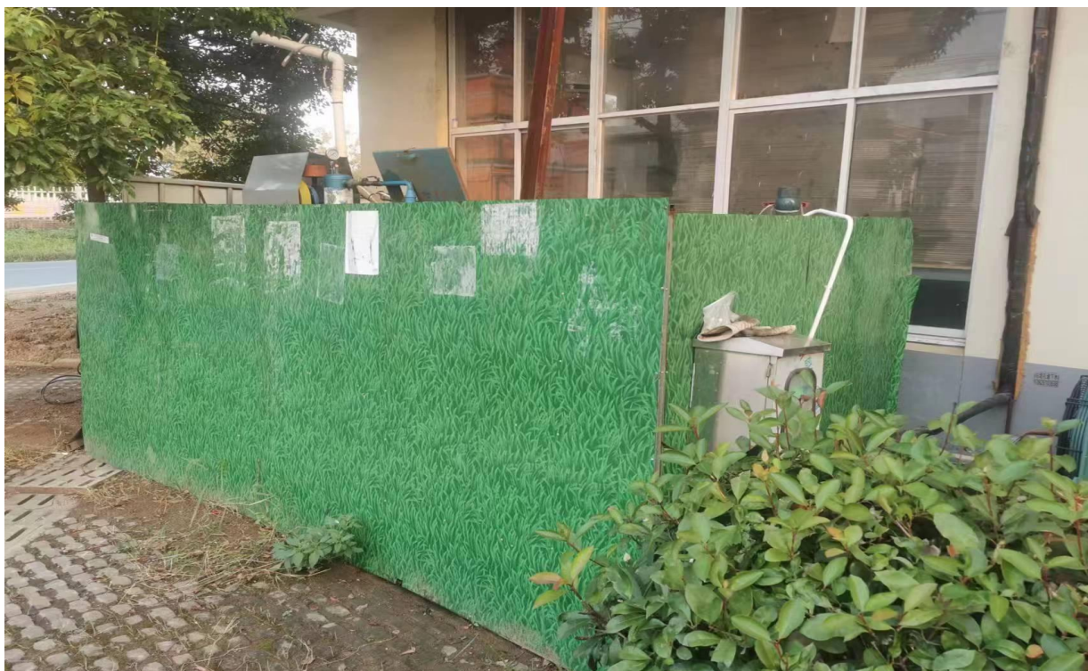
图5 厂区污水处理站污水处理设施
